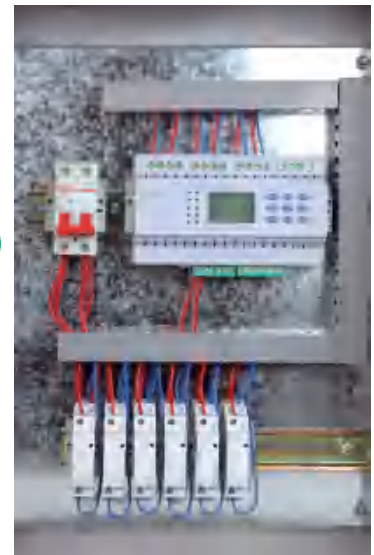
照明控制系统 Lighting Control System
